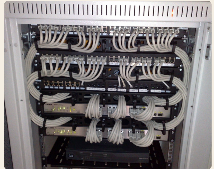
Komutācijas skapis ar paneļiem un slēdžiem
